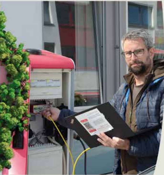
Unsere Ladesäulen werden fortlaufend geprüft.
